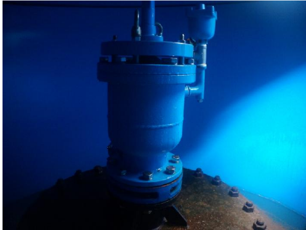
송수계통, 02구간, Sta. No. 65+25.0[A] 밸브 상태양호
