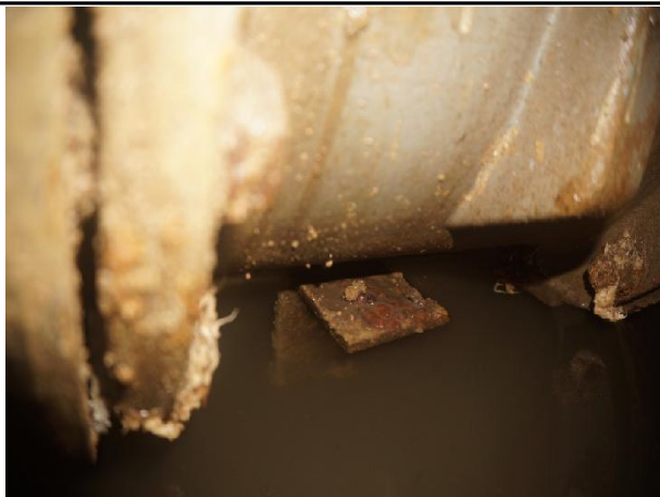
송수계통, 02구간, Sta. No. 2.+17.0[D] 받침콘크리트 미설치
