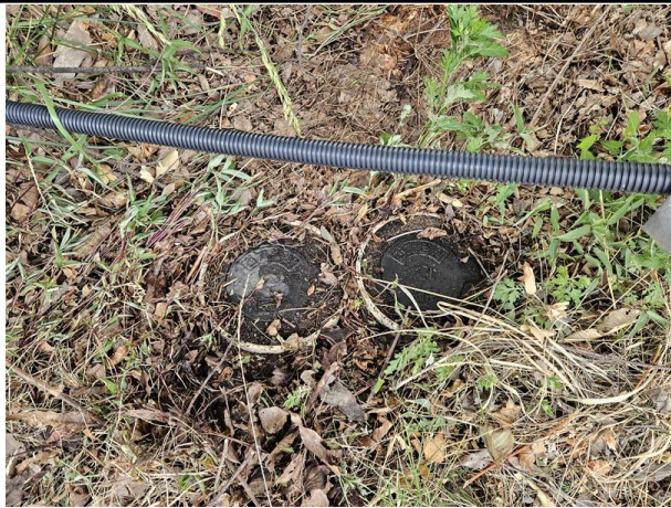
송수계통, 02(03)구간, Sta. No. 45+8.3[A] 공기밸브실 T/B 전경
