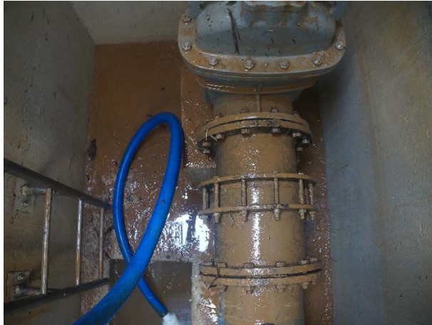
송수계통, 02구간, Sta. No. 67+32.6[D] 배관 및 밸브 상태양호
