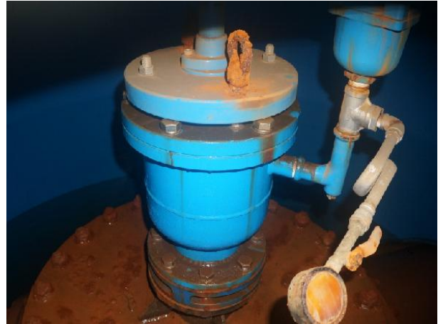
송수계통, 02구간, Sta. No. 84+17.5[A] 밸브 상태양호
