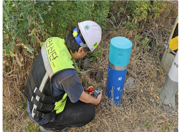
송수계통, 02(01)구간, Sta. No. 15+3.7[A] 공기밸브실 관대지 전위차 측정
