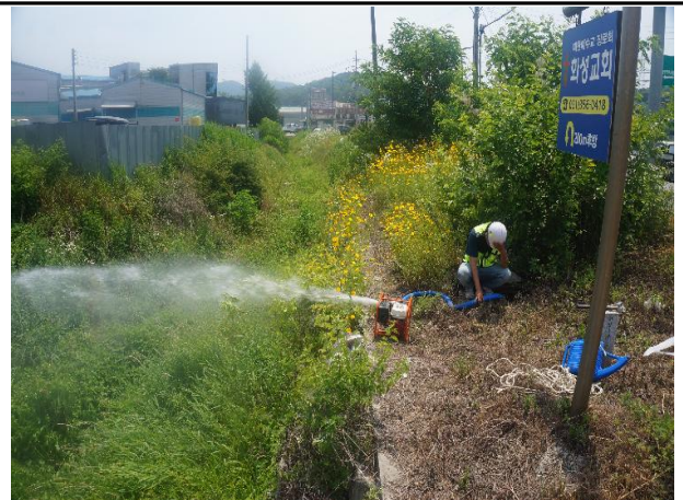
송수계통, 02구간, Sta. No. 108+4.0[D] 밸브실 양수(h=2.0m)
