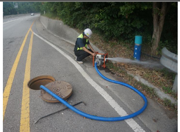
송수계통, 02구간, Sta. No. 45+8.3[A] 밸브실 양수(h=2.0m)
