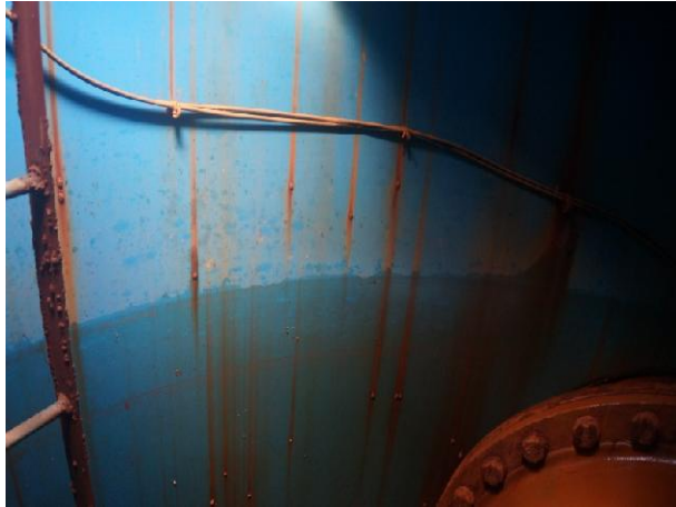
송수계통, 02구간, Sta. No. 1+22.0[A] 강제구조물 표면부식
