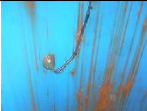
송수계통, 02구간, Sta. No. 15+3.7[A] 강재구조물 국부적 표면부식
