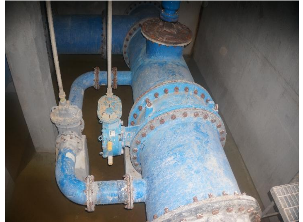
송수계통, 02구간, Sta. No. 109+3.1[Mb] 부관 및 밸브 상태양호
