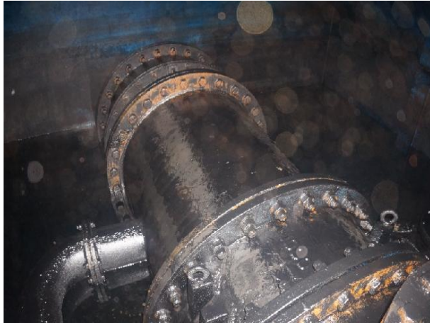
송수계통, 02구간, Sta. No. 34+0.0[M] 빠관 및 밸브 볼트체결부 부식
