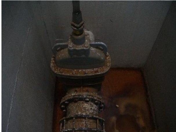
송수계통, 02구간, Sta. No. 31+18.6[D] 배관 및 밸브 상태양호
