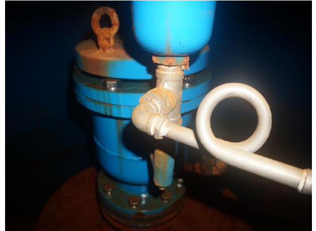
송수계통, 02구간, Sta. No. 45+8.3[A] 밸브 상태양호
