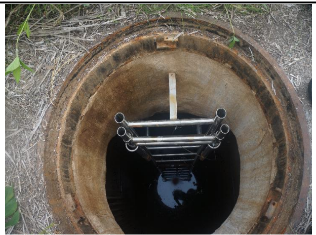
송수계통, 02구간, Sta. No. 67+32.6[D] 이토밸브실 내부 전경
