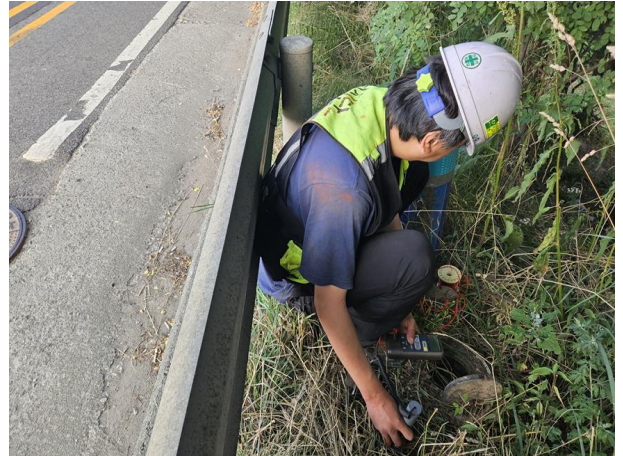
송수계통, 02(03)구간, Sta. No. 67+25.0[A] 공기밸브실 관대지 전위차 측정
