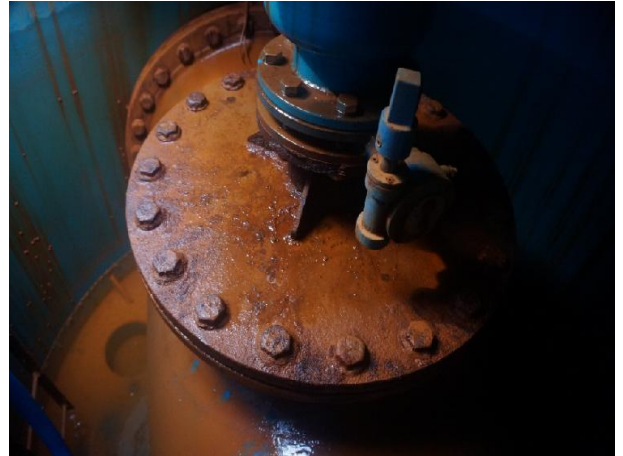
송수계통, 02구간, Sta. No. 1+22.0[A] 마개F 부식
