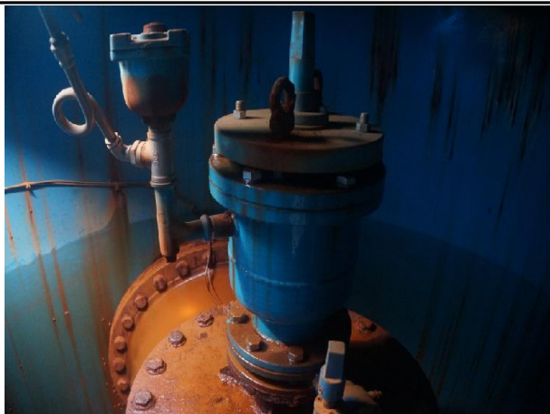
송수계통, 02구간, Sta. No. 1+22.0[A] 밸브 상태양호
