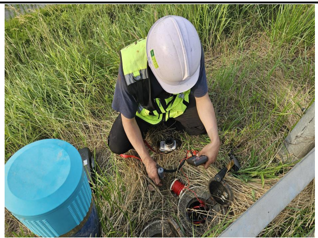
송수계통, 02(01)구간, Sta. No. 1+22.0[A] 공기밸브실 관대지 전위차 측정
