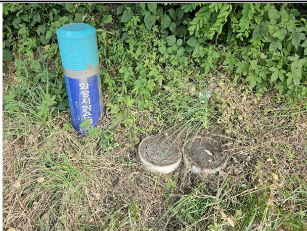
송수계통, 02(03)구간, Sta. No.84+17.5[A] 공기밸브실 T/B 전경
