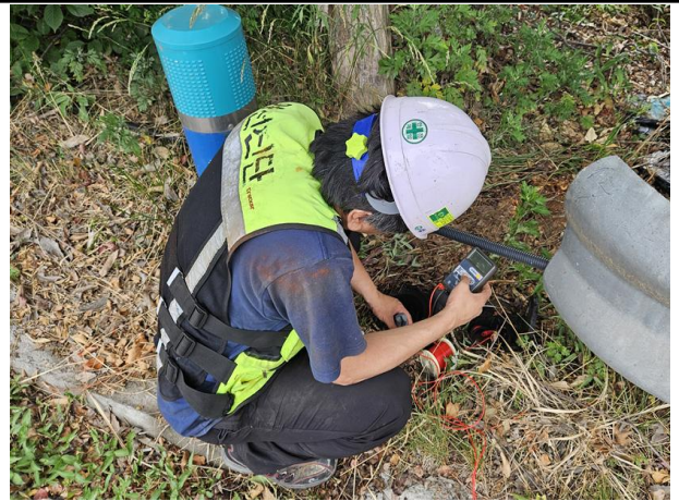
송수계통, 02(03)구간, Sta. No. 45+8.3[A] 공기밸브실 관대지 전위차 측정
