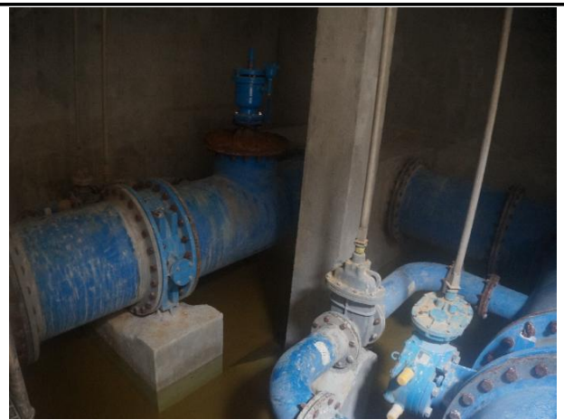
송수계통, 02구간, Sta. No. 109+3.1[Mb] 제수밸브실 내부 전경
