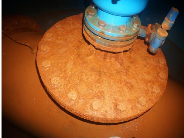
송수계통, 02구간, Sta. No. 45+8.3[A] 마개F 부식
