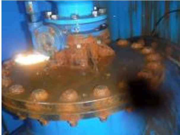
송수계통, 02구간, Sta. No. 15+3.7[A] 마개F 부식
