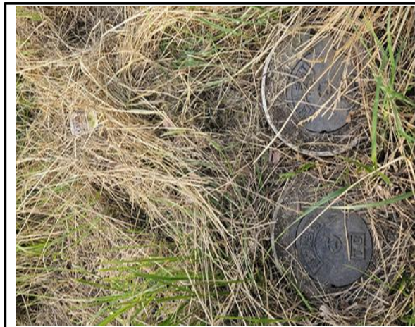
송수계통, 02(01)구간, Sta. No. 1+22.0[A] 공기밸브실 T/B 전경
