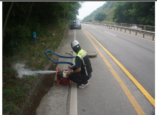
송수계통, 02구간, Sta. No. 84+17.5[A] 밸브실 양수(h=2.7m)
