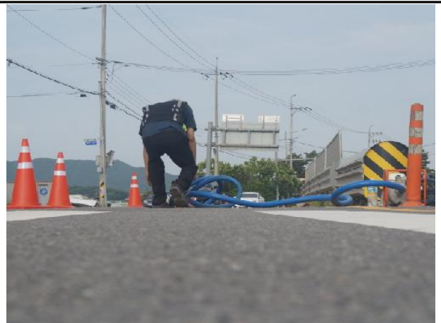
송수계통, 02구간, Sta. No. 15+3.7[A] 밸브실 양수(h=2.6m)
