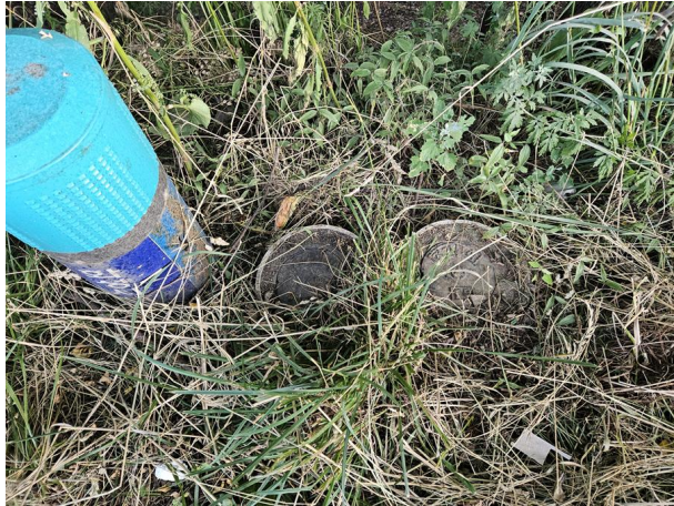
송수계통, 02(03)구간, Sta. No. 67+25.0[A] 공기밸브실 T/B 전경
