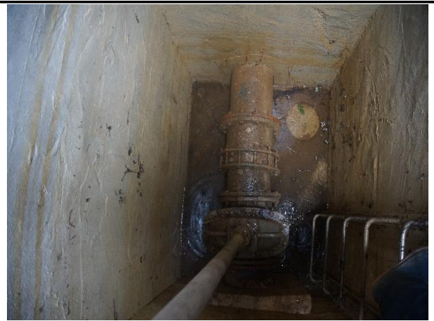
송수계통, 02구간, Sta. No. 108+4.0[D] 이토밸브실 내부 전경
