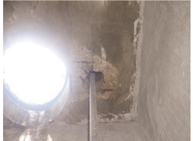
송수계통, 02구간, Sta. No. 108+4.0[D] 상부슬래브 철근노출
