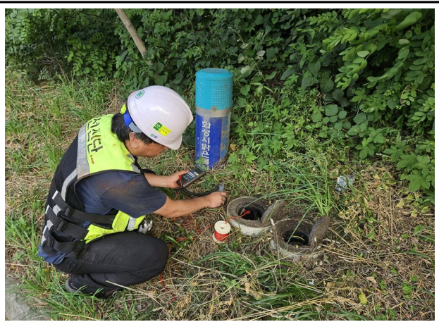
송수계통, 02(03)구간, Sta. No.84+17.5[A] 공기밸브실 관대지 전위차 측정
