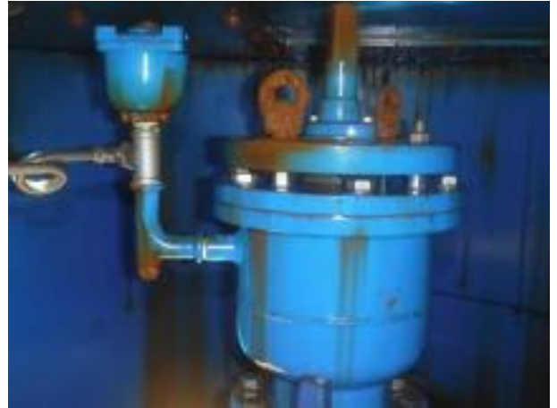
송수계통, 02구간, Sta. No. 15+3.7[A] 밸브 상태양호
