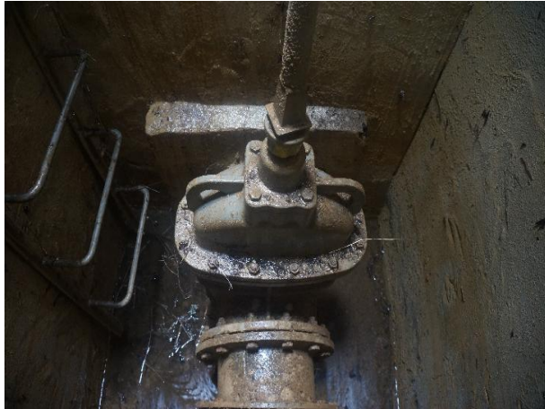
송수계통, 02구간, Sta. No. 108+4.0[D] 배관 및 밸브 상태양호
