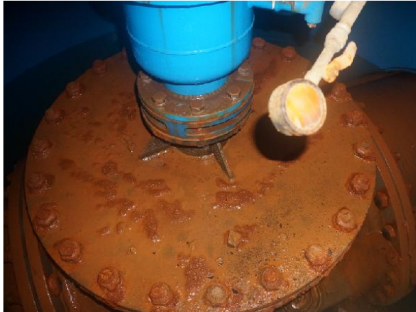
송수계통, 02구간, Sta. No. 84+17.5[A] 마개F 부식
